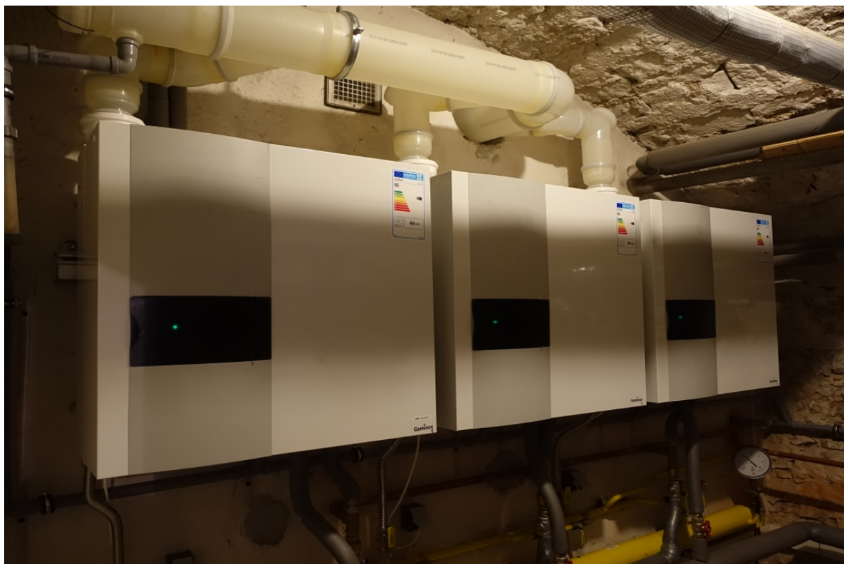
Nově osazené kondenzační kotle v kotelně Arnoldinovského domu
